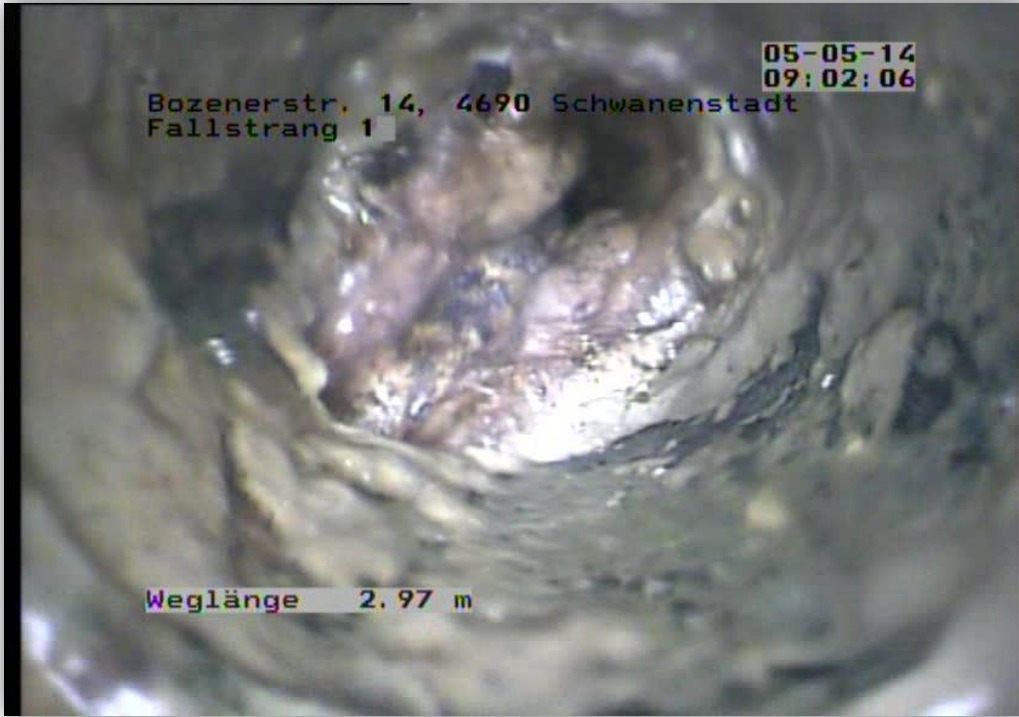
BILD ZEIGT EINEN CA. 50 JAHRE ALTEN MIT FETTABLAGERUNGEN ZUGEWACHSENEN ETERNIT FALLSTRANG
